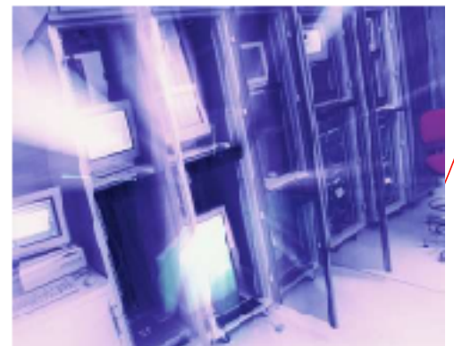
Salle serveurs Protection des baies serveurs
